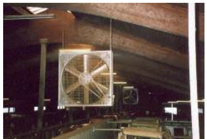
Ein nachträglicher Einbau von Ventilatoren im Laufstall, teilweise auch über dem Melkstand, ist positiv für die Tiere.
